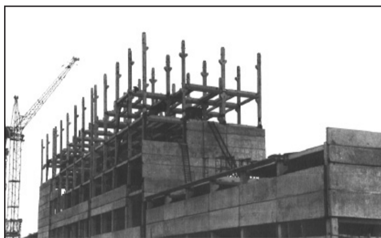
▲ Троицкий комбикормовый завод. Главный корпус. Вид со стороны склада премиксов. Ось «Г». 18.07.1972 г.
